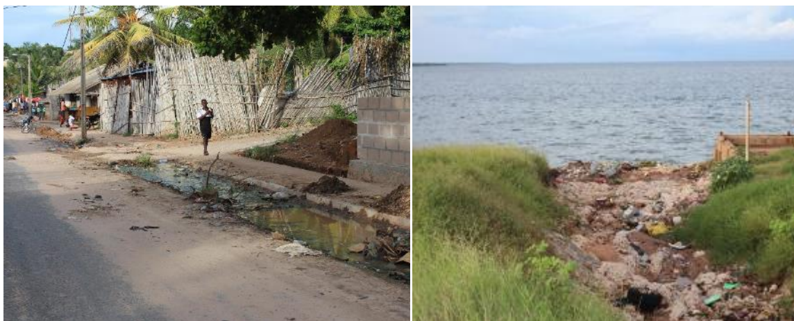
Figuras 5 e 6 - O impacto do lixo nas infra-estruturas de drenagem
