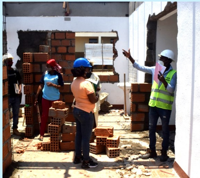
Membros de AP durante vista as obras de construção de bloco sanitário no centro de saúde de Meponda
